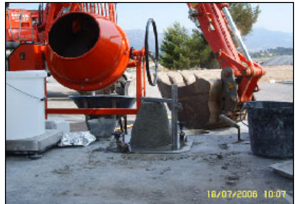
Figure 17 : Bétonnière utilisée pour l'ajout de liants (Source : IN VIVO)
